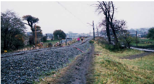
Ryc. 5. Niecka osiadań tworząca się w profilu torowiska kolejowego (Fot. J. Przybyło)
