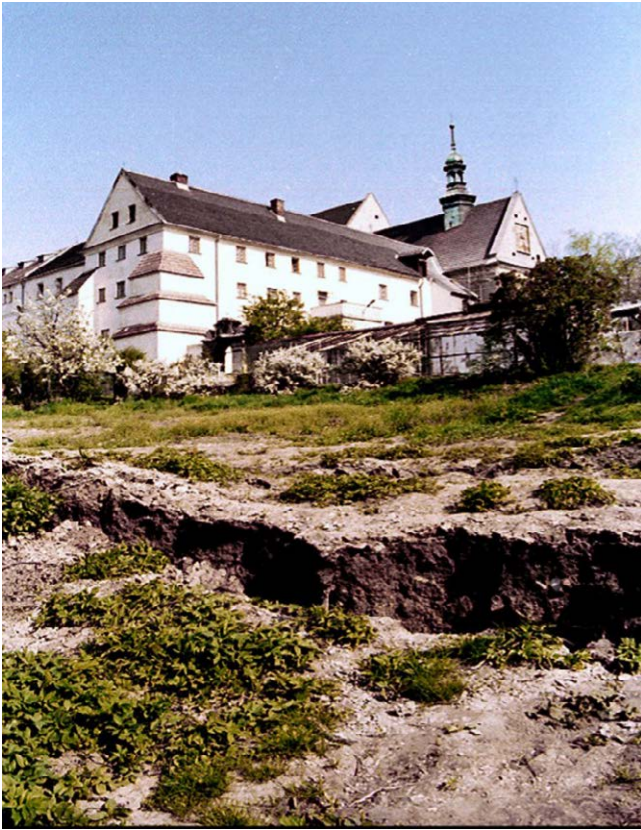
Ryc. 4. Spękania gruntu – deformacje nieciągłe w rejonie klasztoru w Wieliczce (Fot. J. Przybyło)
