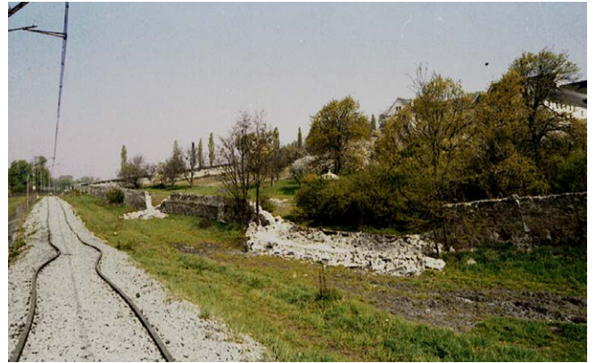
Ryc. 6. Zniszczone tory kolejowe oraz uszkodzony mur klasztorny (Fot. J. Przybyło)
