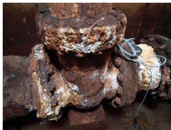
Ryc. 1. Wykwity solne w studni spustowej solanki (Krakowiak i in., 2013)
