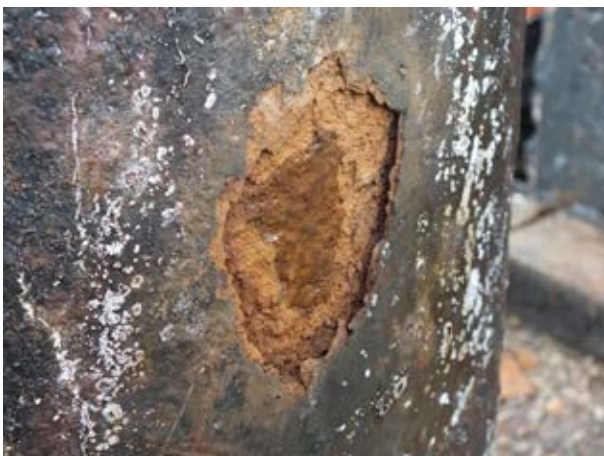
Ryc. 3. Korozja podpowłokowa z utratą przyczepności (Krakowiak i in., 2013)
