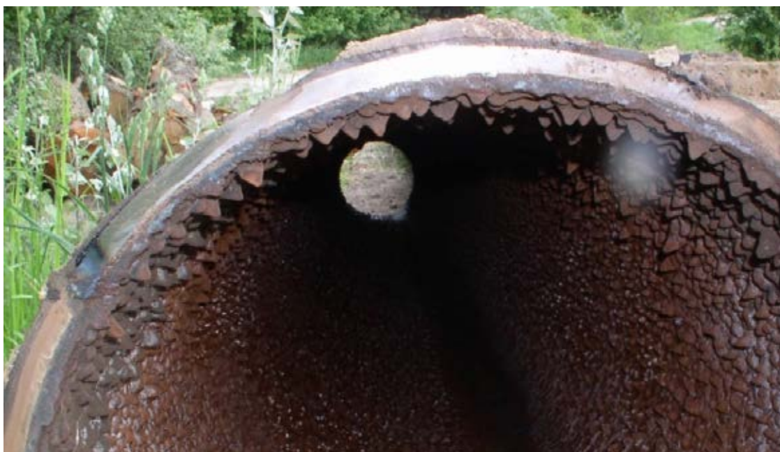
Ryc. 9. Narosty na ściankach wewnętrznych rurociągu solanki DN500
