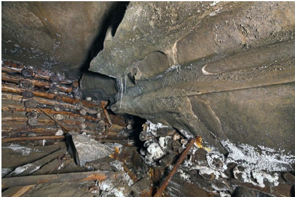
Ryc. 6. Fragment komory Kloski na poziomie V. W ociosie widoczne wylugowania w wyniku działania nienasyconych wód w czasie katastrofy wodnej z lat 1868-1879. Stan na luty 2017. Komora jest obecnie zlikwidowana zaczynami uszczelniającymi. Fot. J. Przybyło.
