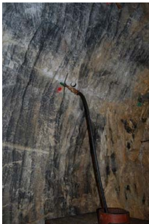
Ryc. 5. Aktualne ujęcie wycieku.
