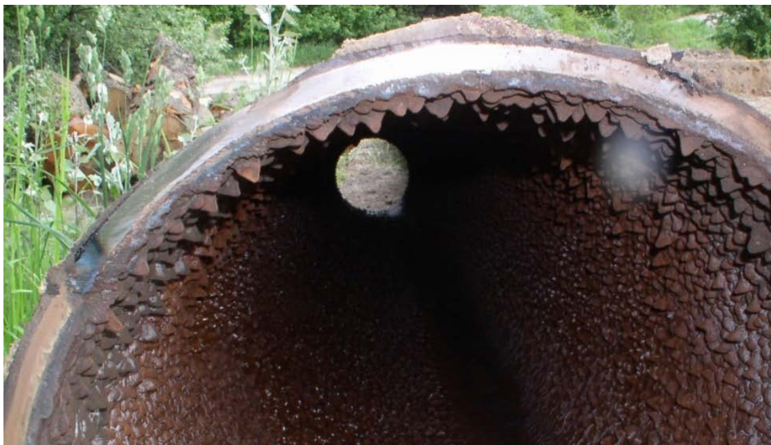
Ryc. 9. Narosty na ściankach wewnętrznych rurociągu solanki DN500
