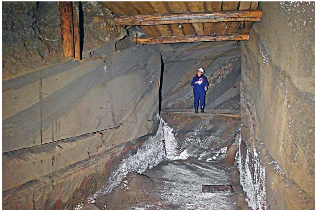
Ryc. 12. Wyrobisko zlokalizowane przy poprzeczni Colloredo 2. Widoczne podługowania ociosu w wyniku działania nienasyconych wód w czasie katastrofy wodnej z lat 1868-1879 Stan na listopad 2014.
