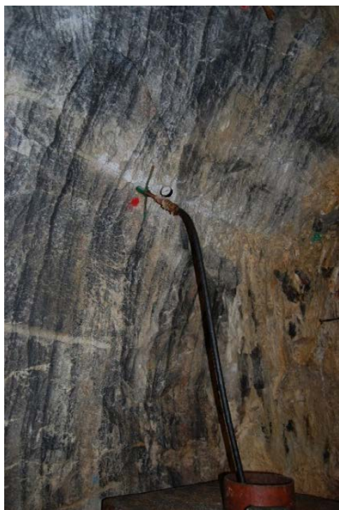
Ryc. 5. Aktualne ujęcie wycieku.
