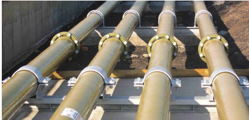
Ryc. 4 Rurociąg wykonany z rur z włókna szklanego
