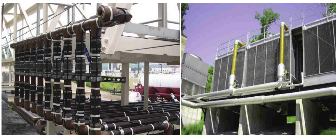
Ryc. 3 Instalacje wykonane z rur z włókna szklanego
