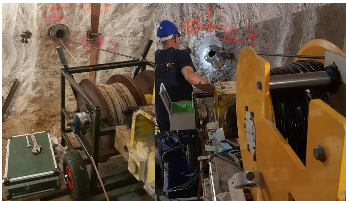
Ryc. 4. Liny i wciągarki kablowe służące do przemieszczania sond radarowych w głębokim poziomym otworze wiertniczym.
