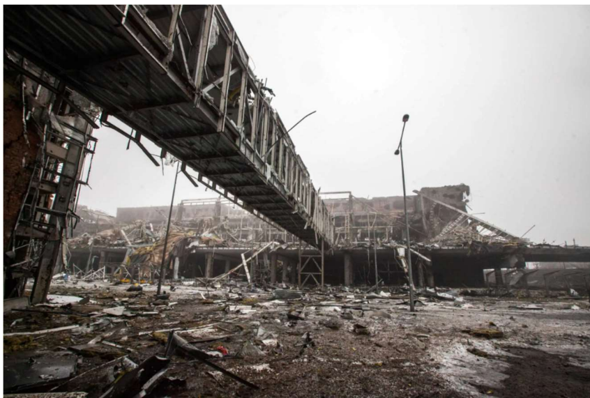
Rys. 2. Zniszczony port lotniczy, Donieck 21.01.2015 r. (fot. Igor Ivanov – AP) [12] Fig. 2. Destroyed airport, Donetsk, 21 January 2015 (photo: Igor Ivanov – AP) [12]
